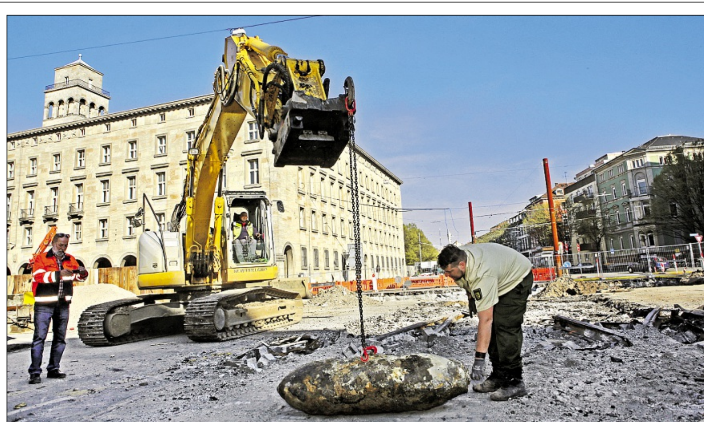
BEI BAUARBEITEN an der Karlsruher Kombilösung wurde eine 500-Kilo-Bombe aus dem Zweiten Weltkrieg entdeckt. Spezialisten des Kampfmittelbeseitigungsdienstes entschärften gestern die Fliegerbombe. Foto: jodo
